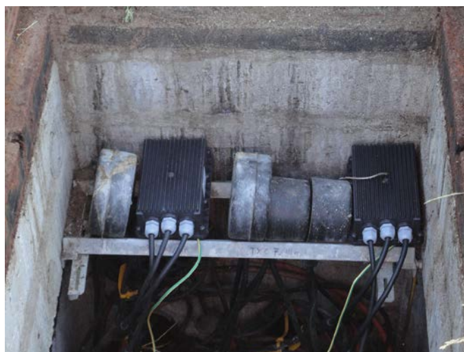
Bild 3: Halterung für die Lampentransformatoren im Kabelschacht
